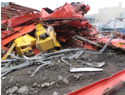
1. Oplag af nedtaget materiale med restprodukter opbevares på ubefæstet område
