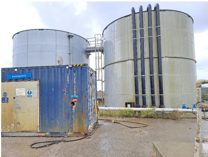
Tanke til opbevaring af vand ved intern renseanlæg areal 6.
