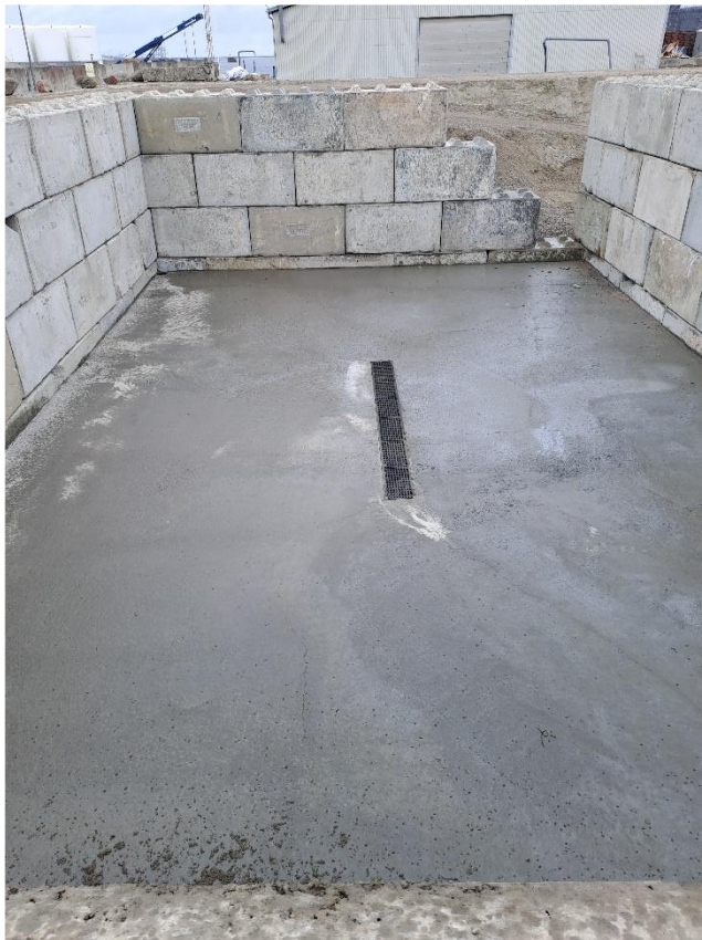
Nye kar i lagunen, areal 8, hvor der ses revner i betonen
