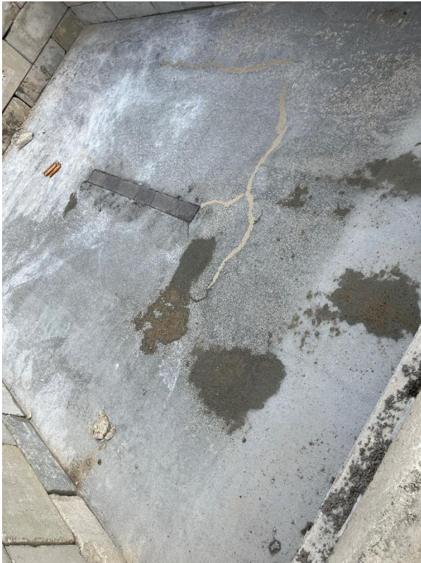
Fotodokumentation fremsendt den 2. september af udbedringer af revner i nye kar, lagunen, areal 8.
