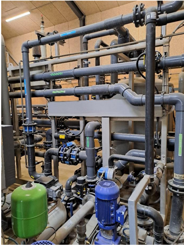
Internt renselanlæg, hvor prøvetagningsbrønd til spildevandsanalyse er.
