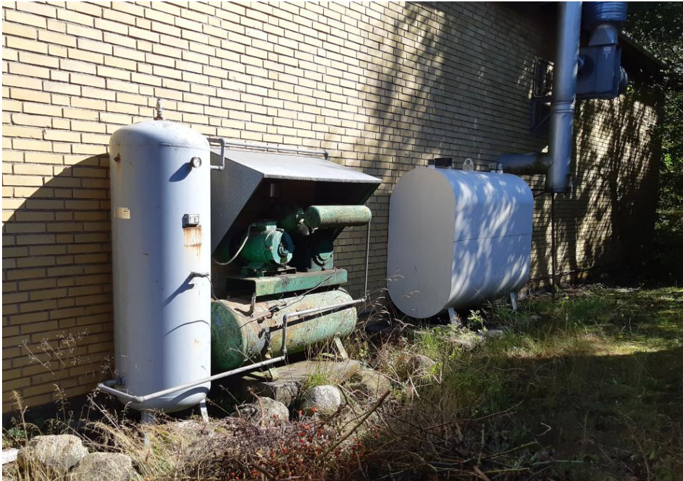
Fyringsolietank og gammel kompressor
