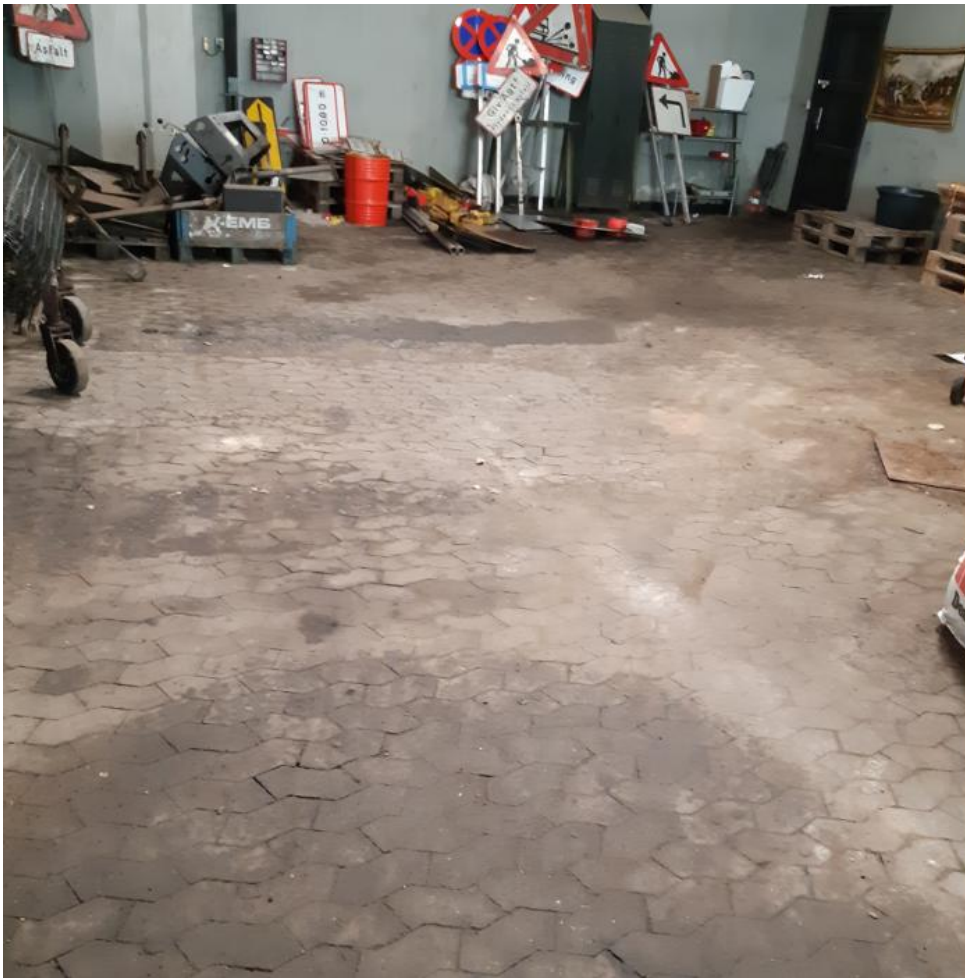
Garage – gulv med oliepletter
