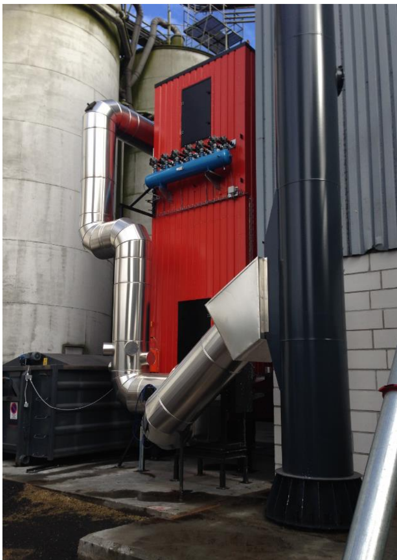
Nyt filteranlæg, askecontainer og skorsten
