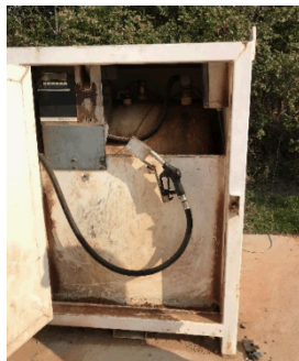
Dieselolietank i aflåst container på påfyldningsplads
