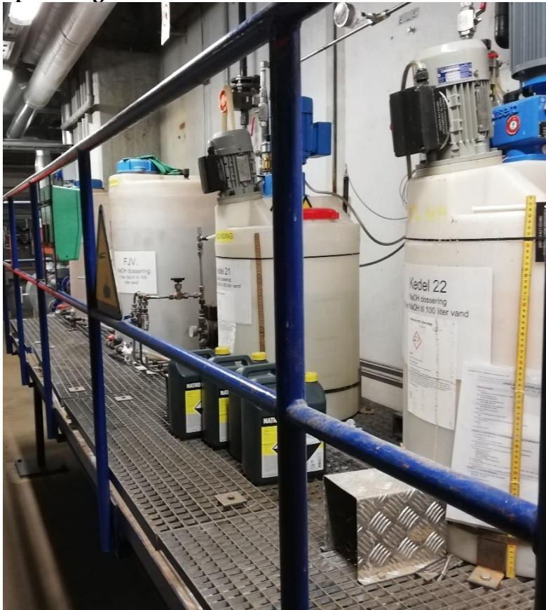
Bilag 3: Kemikalier der anvendes i Mix bed anlæg til vandbehandling opbevares på opsamlingskar.
