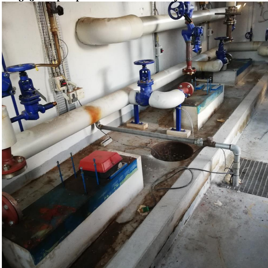
Bilag 13: Oliepumper til letolietanken er fjernet
