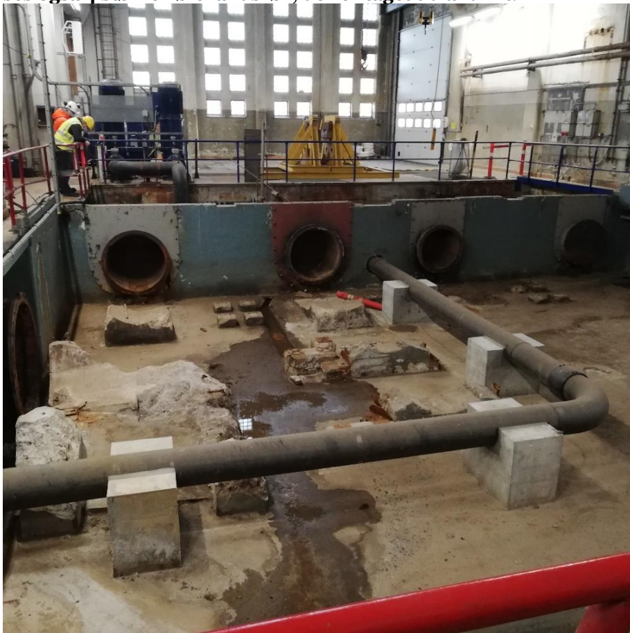
Bilag 5: Vandsledning i brug (Sort plast) til indtag af kølevand fra Svanemøllehavnen. Der ses også 4 større kølevandsrør, der er taget ud af drift.
