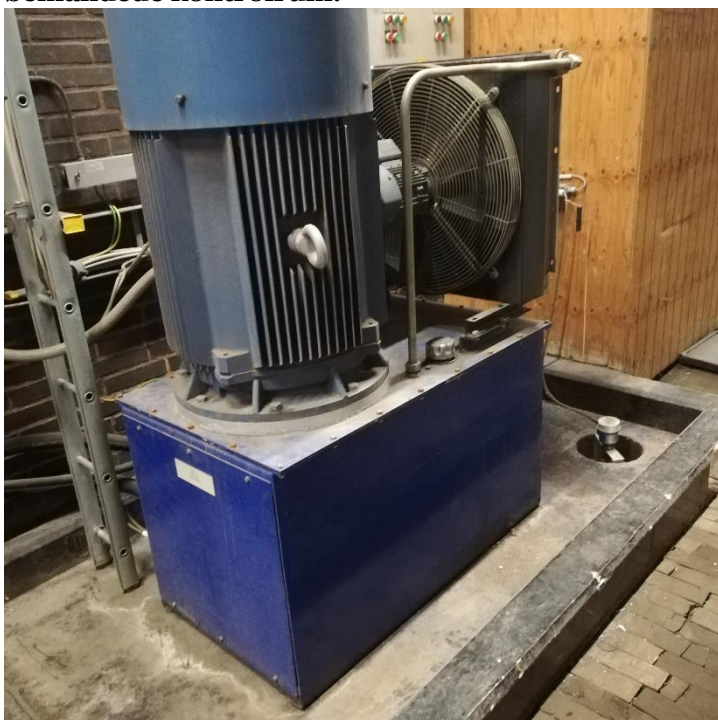
Bilag 6: En hydraulisk motor med tilhørende hydraulikolietank driver en neddykket cirkulationspumpe i kølevandskanalen under kedelbygningen. Til højre ses alarm monteret i rund fordybning i betonosamlingskar. Alarm er tilsluttet Avedørevætkets bemandede kontrolrum.
