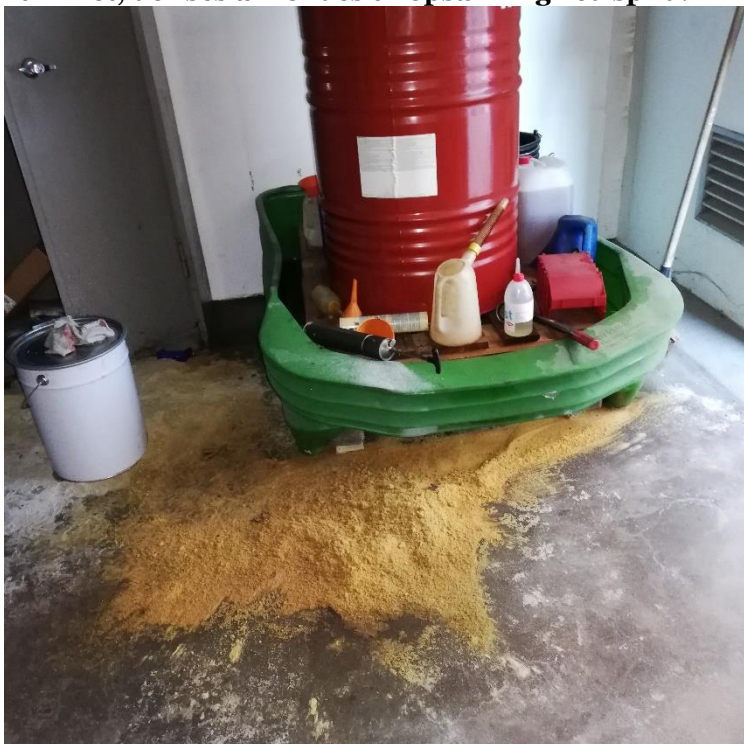
Bilag 11: Beholdere med olie i lagerbygning nord for blokbygningerne. Der er absorberent i rummet, der ses anvendes til opsamling ved spild.
