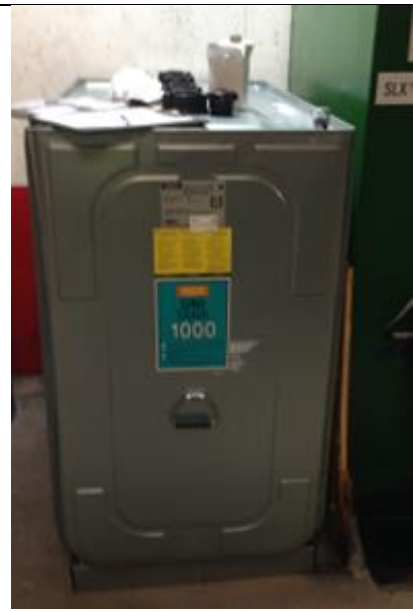
Fig. 2 Ny dobbeltvægget tank
