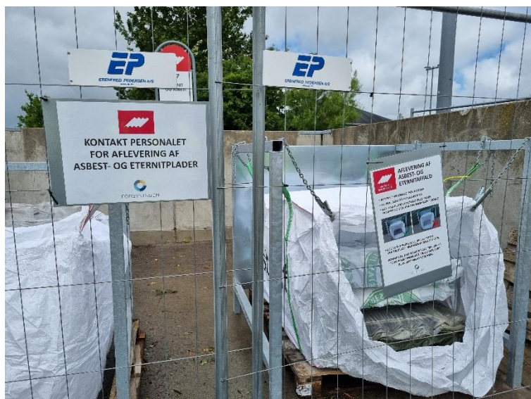
Billed 1. Aflåst bås til asbestaffald.
