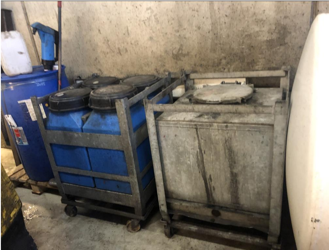
Billede 1. Containere i vaskehallen, som er placeret uden spildbakke.
