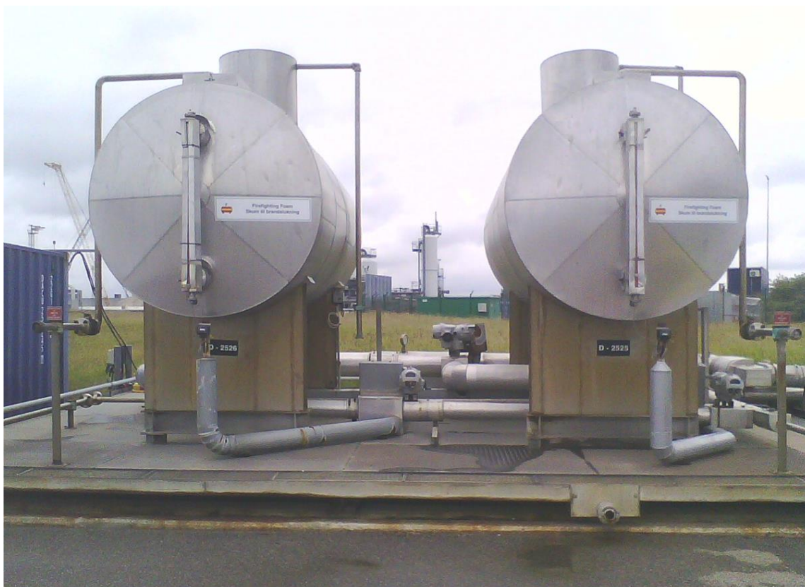
Figur 2: Billede af skumtanke på Pier. Billede er taget fra vest mod øst.
