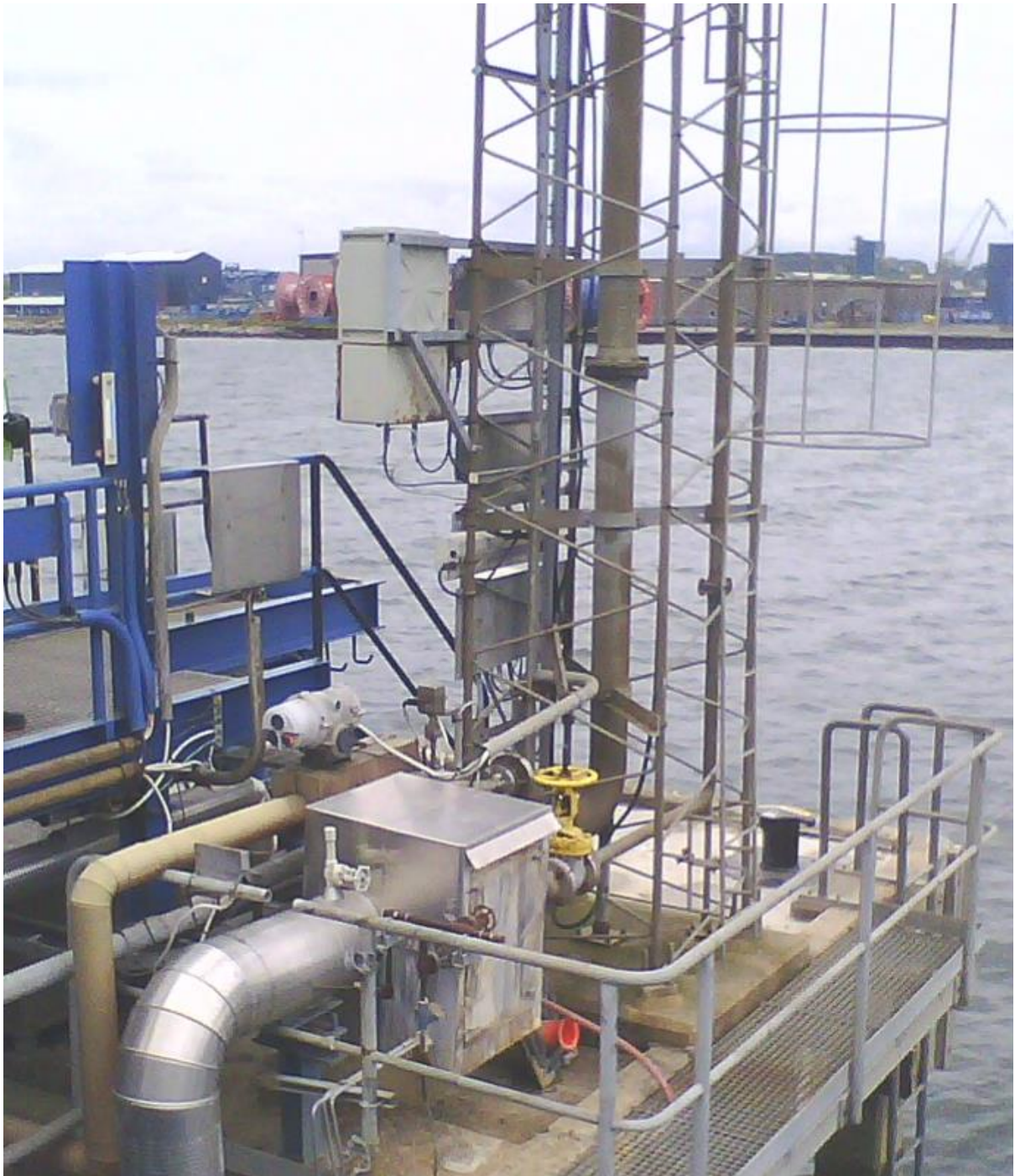
Figur 5: Billede af skuminstallation på Pier C – Samme system som på billede 3 & 4, bare set fra sydøst mod nordvest.
