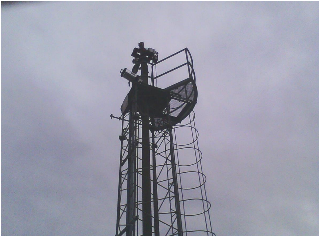
Figur 3: Billede af skumindstallation på Pier C – øverste del. Billede er taget fra syd mod nord
