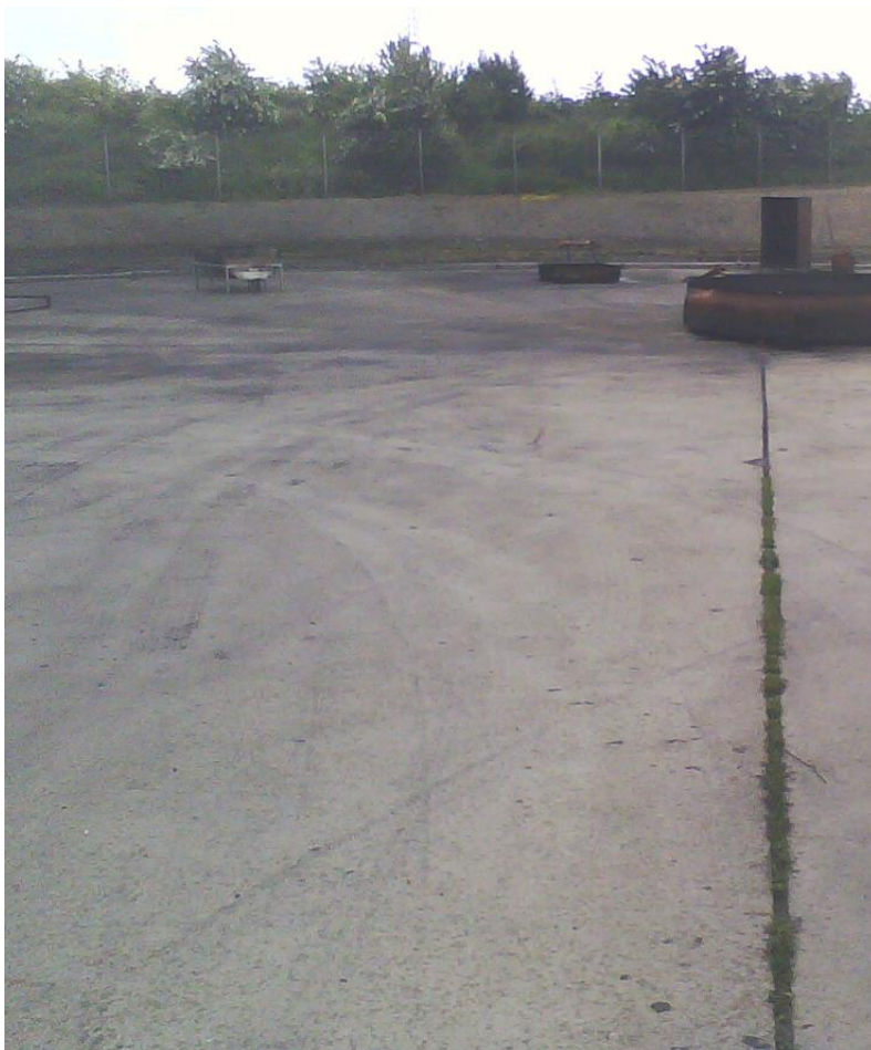
Figur 10: Billede fra brandøvelsepladsen. Billede af defekt fuge. Billede er taget fra nord mod syd.
