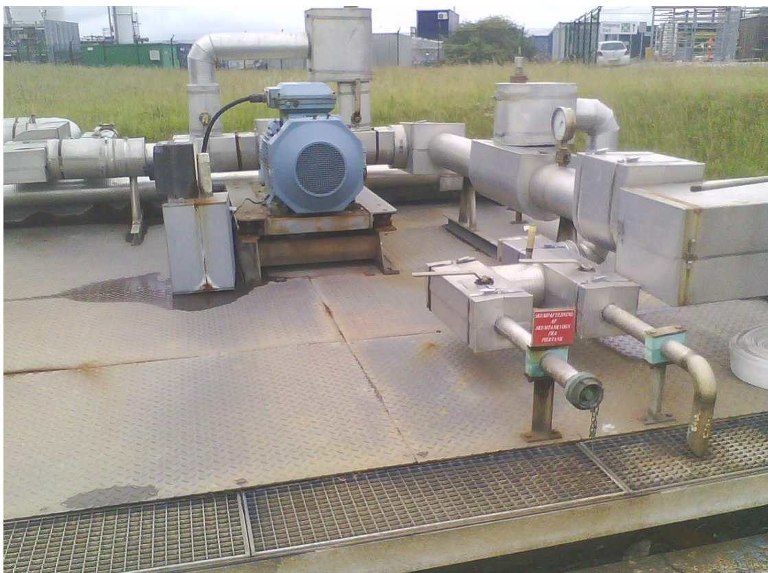
Figur 1: Billede viser skumindstallation på Pier. Billede er taget fra vest mod øst. Skumtanke står til venstre.
