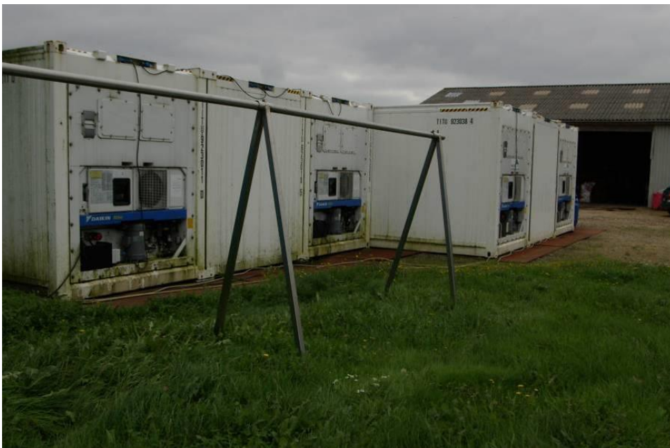
Foto 4: DAIKIN kølecontainere set fra vest, af de i alt 8 kølecontainere er de 2 uden kompresor anlæg
