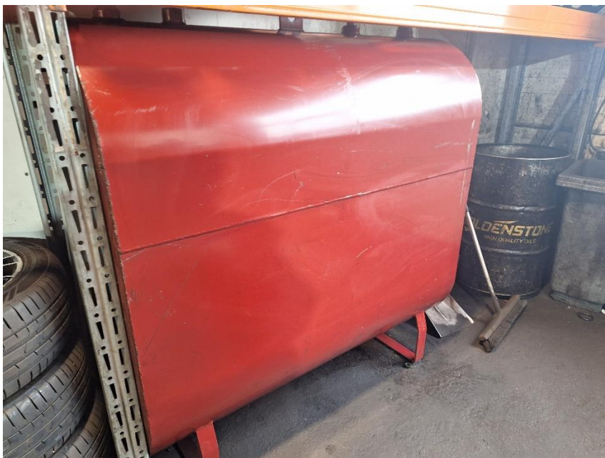
Opsamlet olie opbevares i en stor olietank der bliver tømt efter behov.
