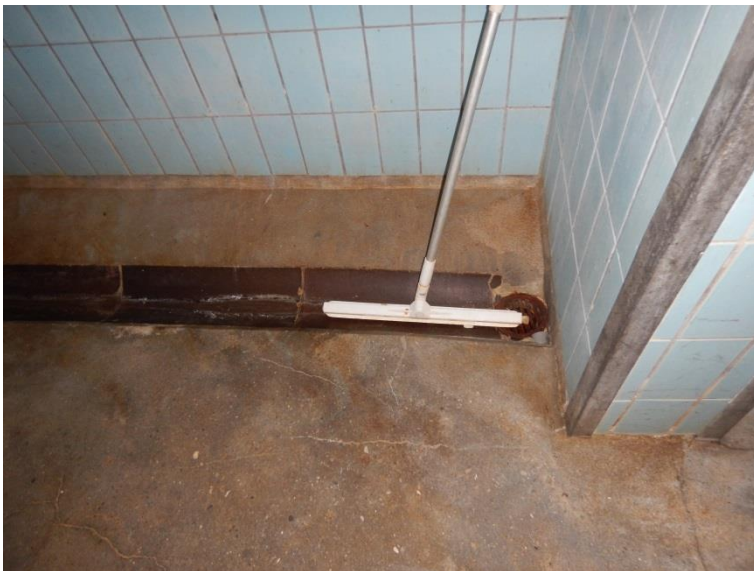
2. Afløb til vaskevand.
