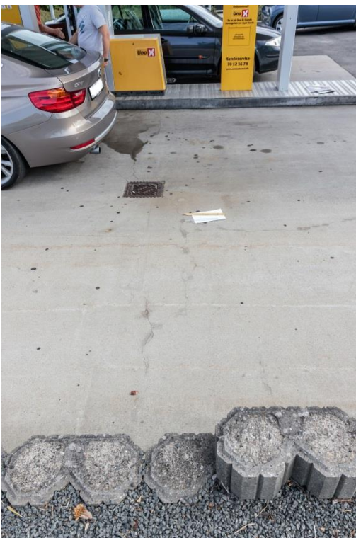
Foto 6 Punkt 2: Revne i betonbelægning på salgspads (set fra syd).
