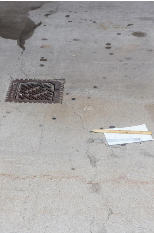
Foto 7 Punkt 2: Revne i betonbelægning på salgsplads (set fra syd).
