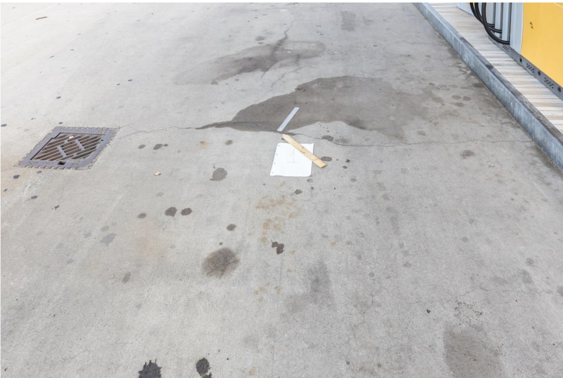
Foto 4 Punkt 1: Revne i betonbelægning på salgspads (set fra øst).
