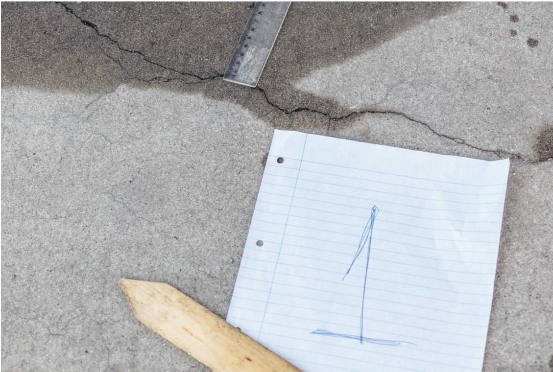
Foto 5 Punkt 1: Revne i betonbelægning på salgspads (set fra øst)
