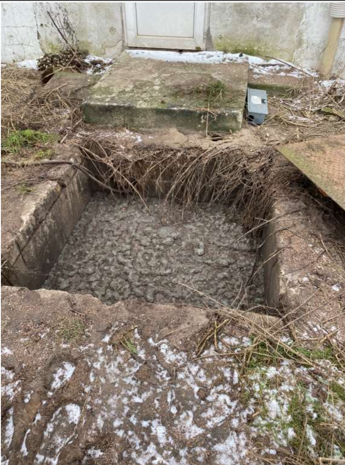
Overløb af gylle fra tørbrønd samt intet låg på tørbrønd.
