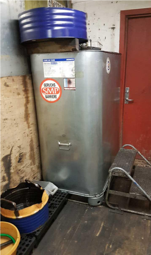
Dobbeltvægget spildolietank fra 2001.
