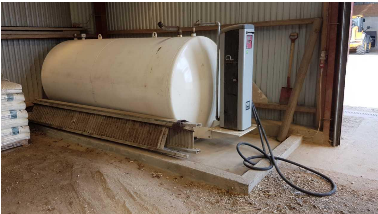
Ny dieselolietank fra 2014.
