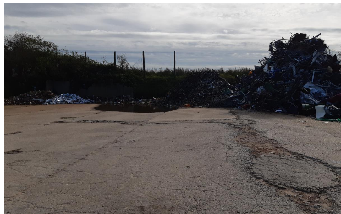
Figur 6. Område 3 øst for plads 5 med oplag af metal og ødelagt belægning.
