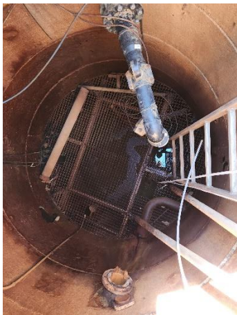
Foto 6: Det indre af perkolatpumpebrønd PB2
