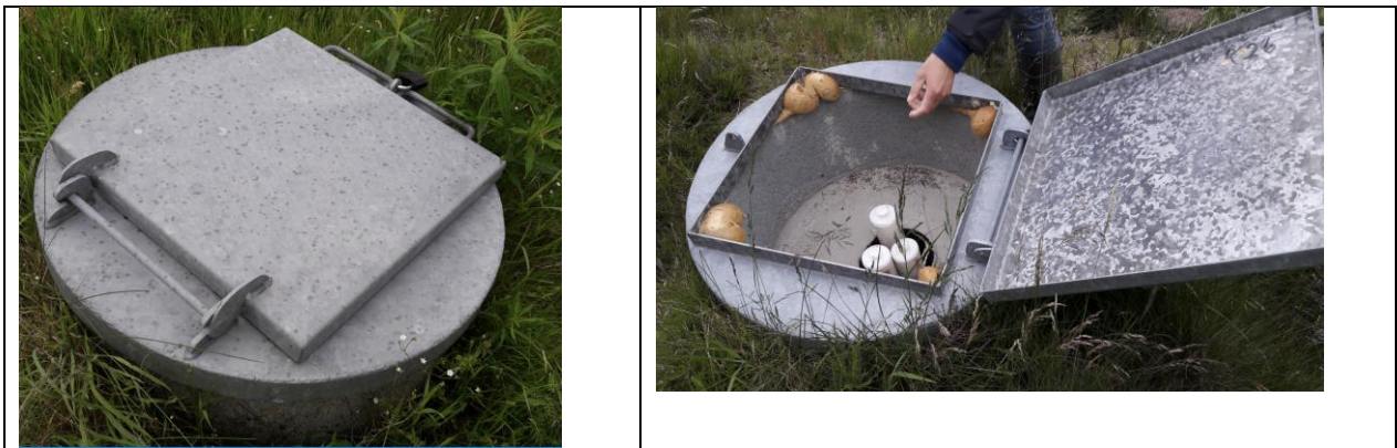
Boring K26 med beskyttelsesbrønd, og aflåst låg.
