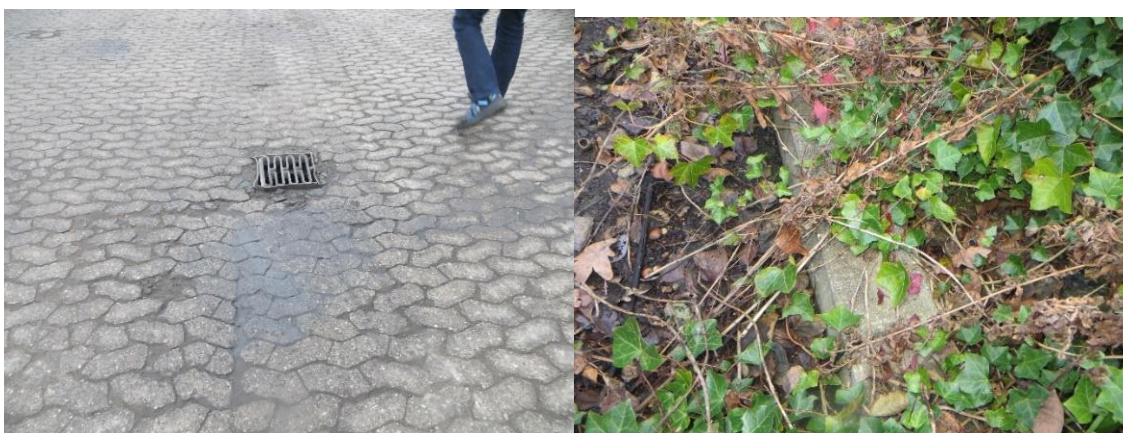
Belægningen er generelt i dårlig stand. Der er ikke et tydeligt fald mod afløb på arealet, men virksomheden oplyste, at der er en effektiv opkant langs belægningen ud mod å siden. Afløb føres til offentlig kloak.
