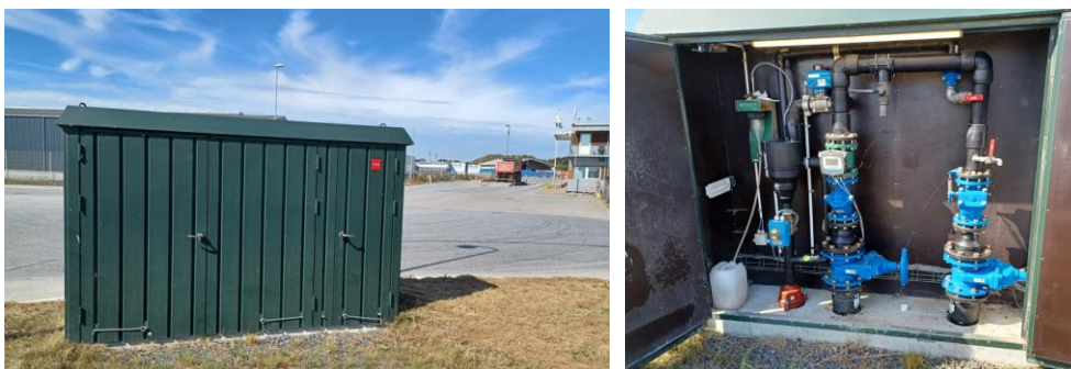
Fotos af skab til udtagning af prøver af overskudsvand/drænvand.
