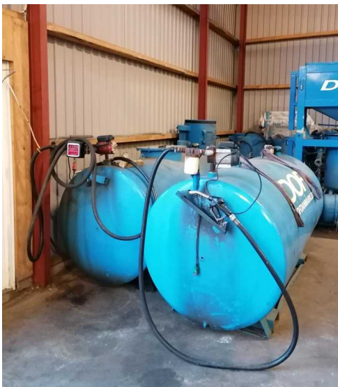
Tank til venstre er permanent opstillet på Sandholm 55M. Tank til højre hører til på Ralvej 6.
