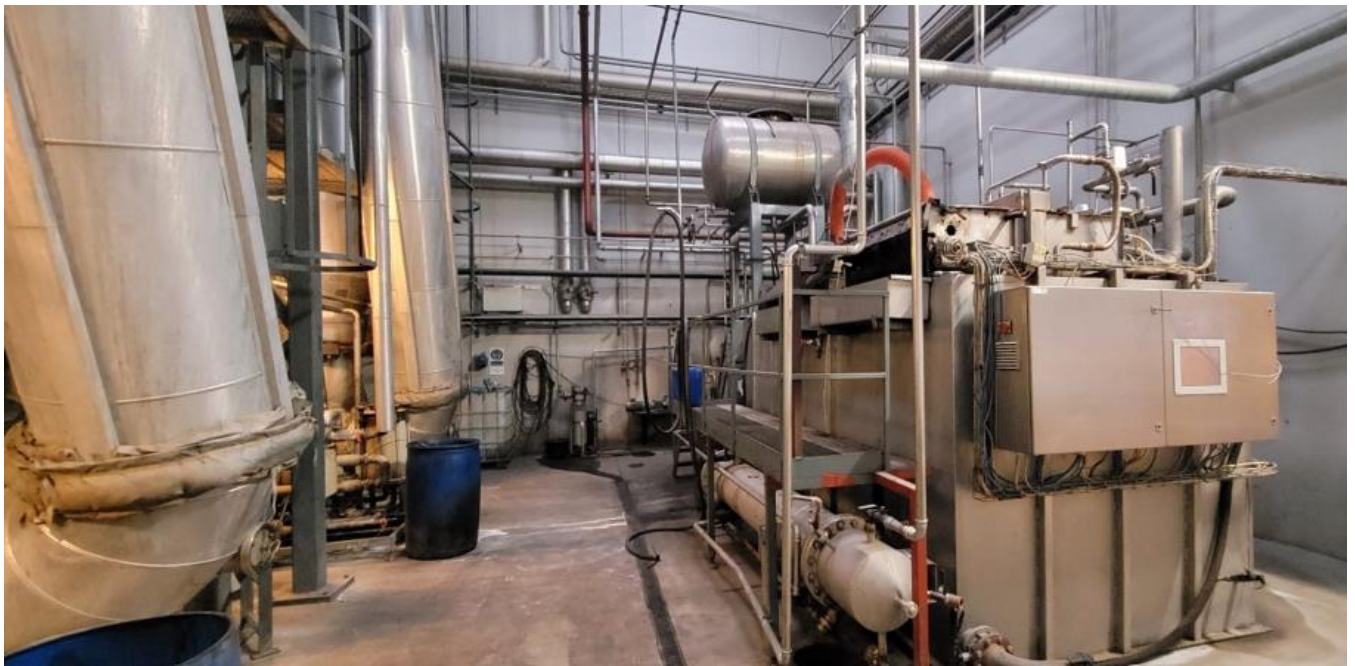
Ultrafiltreringsanlæg, som benyttes til behandling af vandigt farligt affald.
