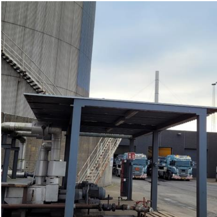
Pumpehus ved den store tankgård.
