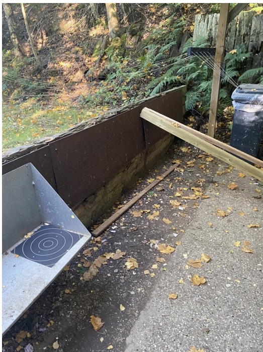
Væggen skal renoveres (foto fra 2022)
