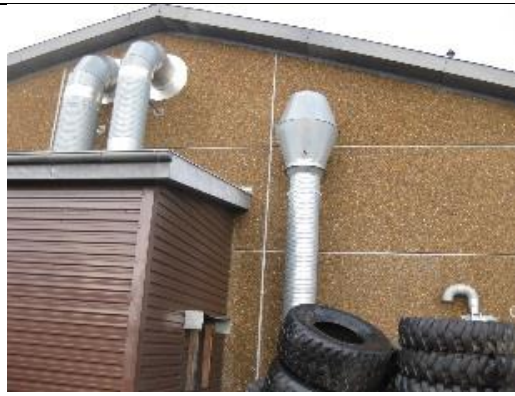
Afkast for rumventilation
