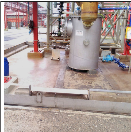
Pumpeforlag B0450 på P2-anlægget (MRa). Mobil opkant i forgrunden.
