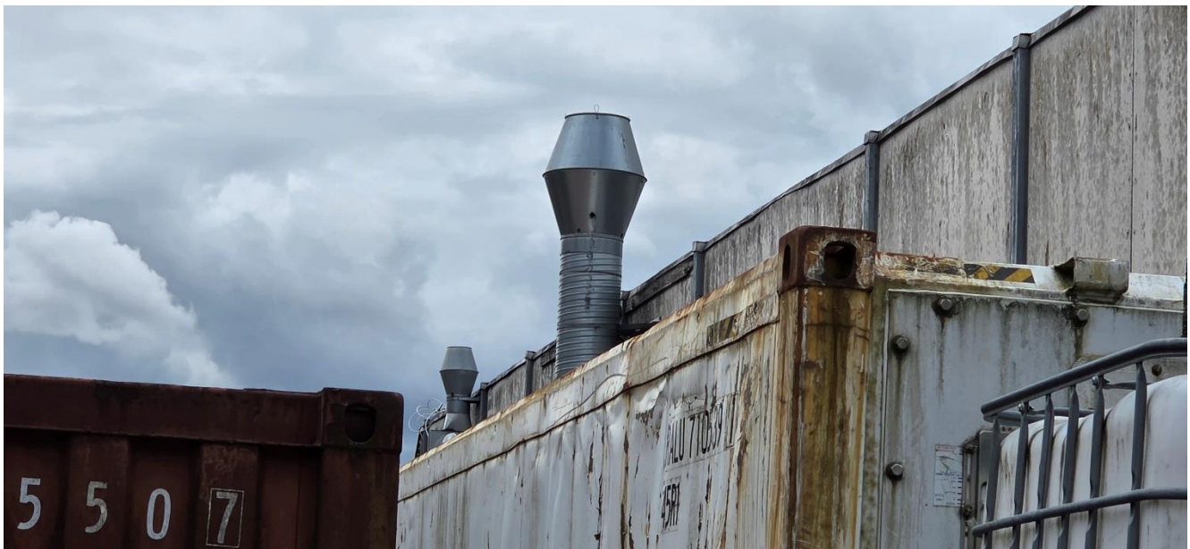
Virksomhedens ventilationsafkast. Nærmeste er for rumventilation og fjerneste er til punktudsugninger ved liftene. Den fjerneste vurderes ikke at være tilstrækkeligt højt.
