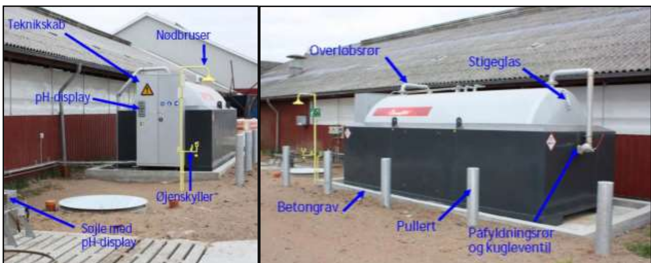
Figur 3. Opbygning og placering af syretank, betongrav, pullerter, påfyldningsrør, stieglas, overløbsrør, teknikskab, nødbruser etc.
