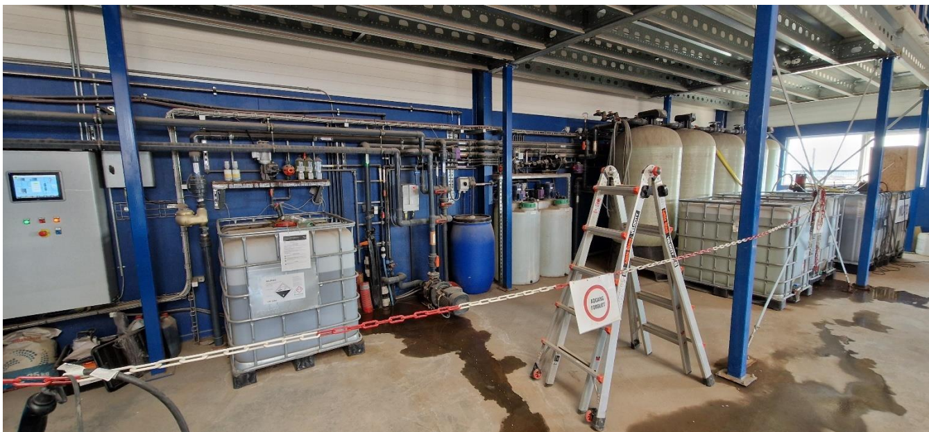
Anlæg til spildevandsrensning med i alt 5 filterkolonner.
