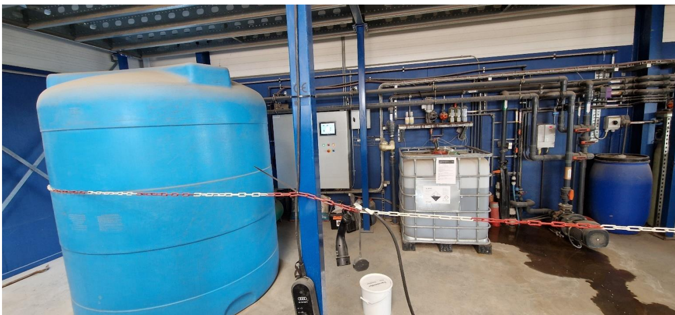
Den lyseblå tank benyttes til rensset spildevand.
