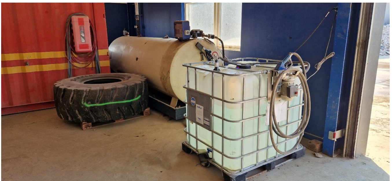
Dieseltanken er dobbeltvægget og står på drypbakke. Palletank med AdBlue står uden spildsikring.
