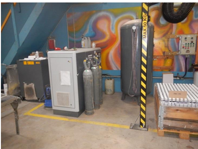
5. Kompresserrum /CO2 anlæg
