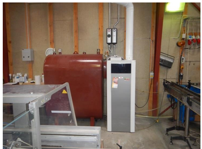
6. Olietank og oliefyr
