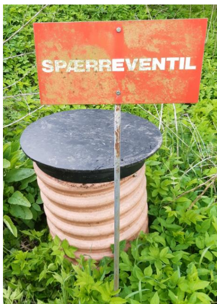
Billede 27 Spærreventil til overfladevand fra sorterings- og mellemlagerplads.
