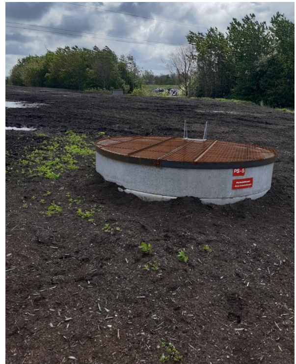
Billede 18 Perkolatbrønd PS-5 placeret i etape 4.
