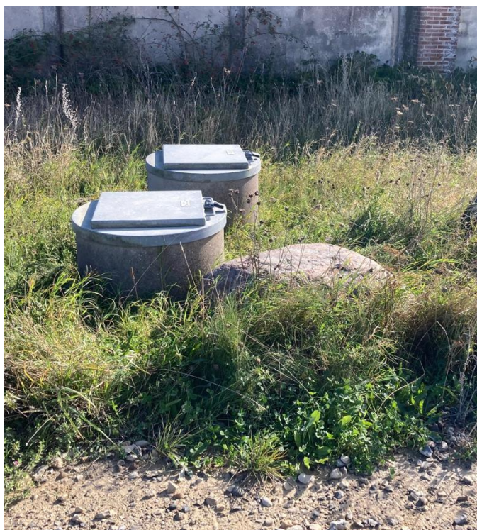
Foto 3. B4 ligger foran hallen. Boringen har 2 filtre.
