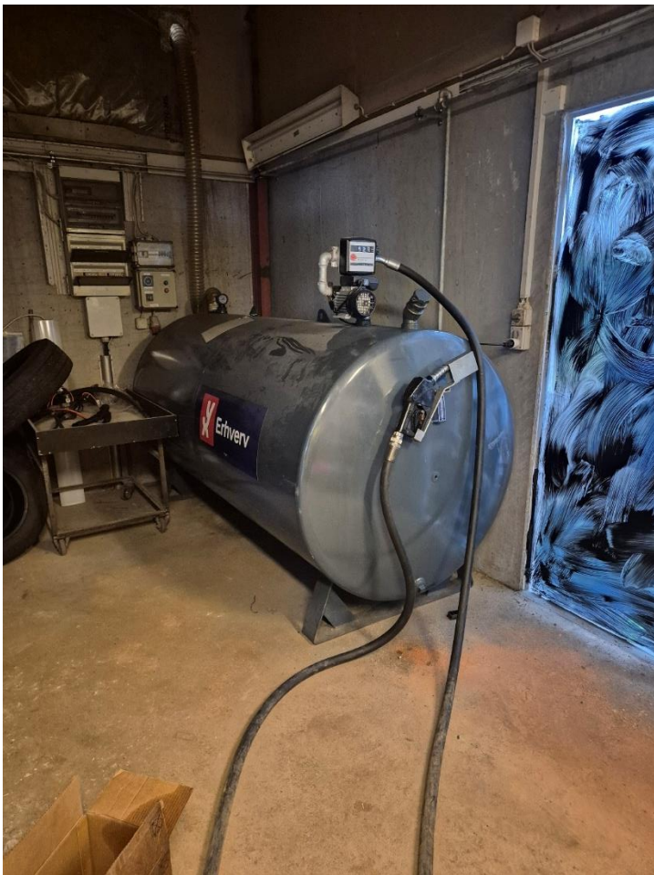
Figur 9. Nyere olietank fra 2022. Gulv er pænt og uden tegn på spild.
