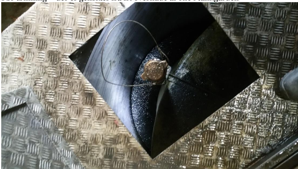
Efter tømning- tanken tømt, studsene lukket. Bunden af tankgården er sort af olie.
