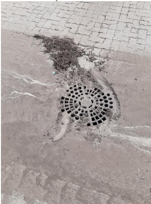
Figur 9 Blokeret afløb, der blev skrabet fri for jord under tilsynet.
