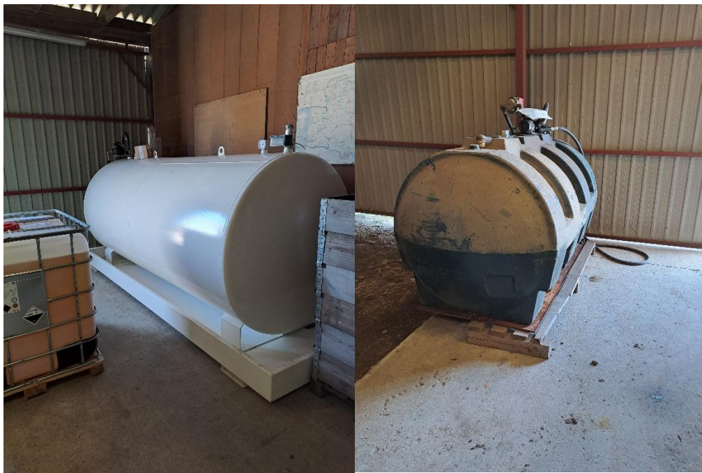
Figur 7: Til venstre ny etableret olietank, til højre gammel olietank som er til salg.
