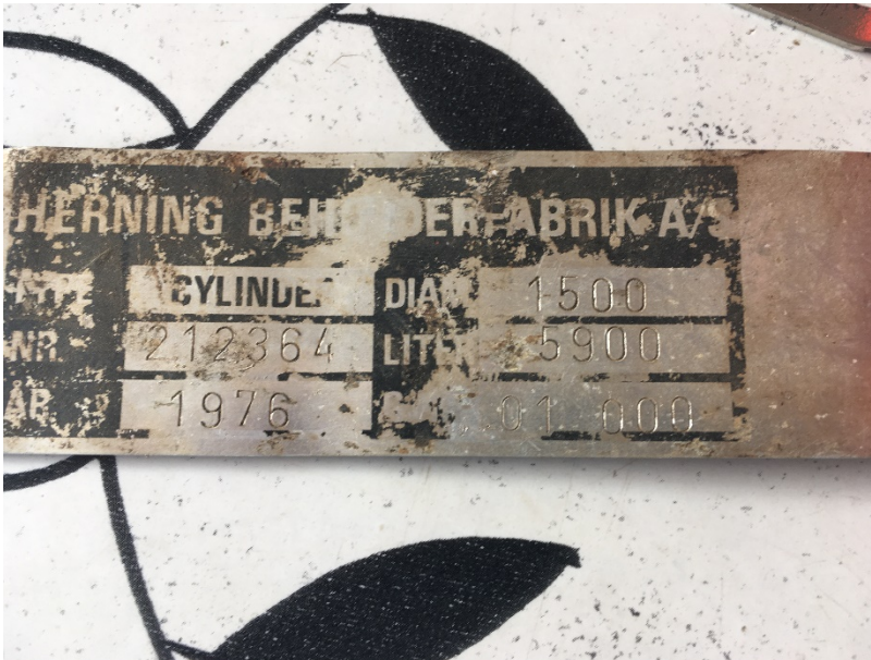
Tankplade tilhørende olietank til dieselolietankning (teknisk anlæg 2 i BBR).
