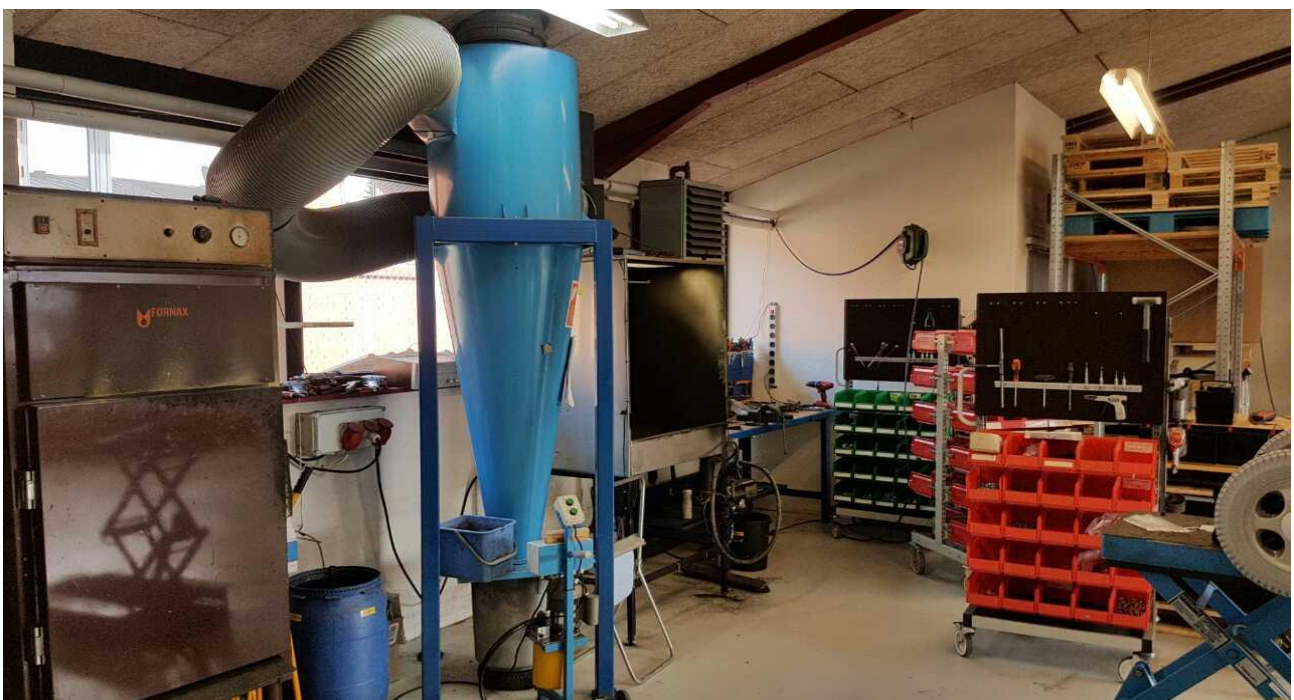
Pulvermalingskabine med tilhørende cyklonfilter.
