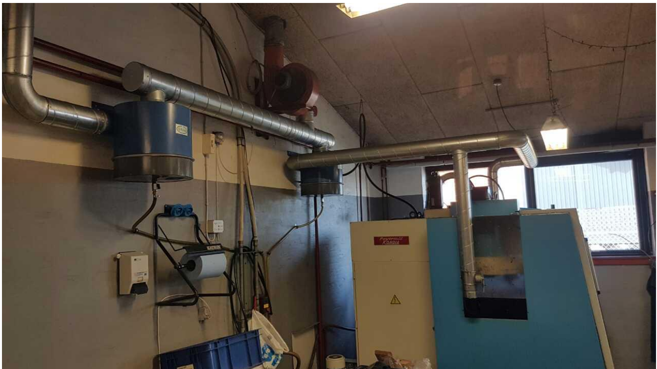
Udsugning fra spåntagende forarbejdning med tilhørende olietågefilter.
