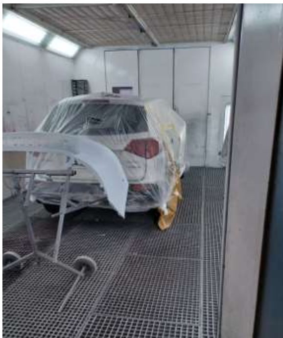
En af sprøjtekabinerne – filtre i gulv
