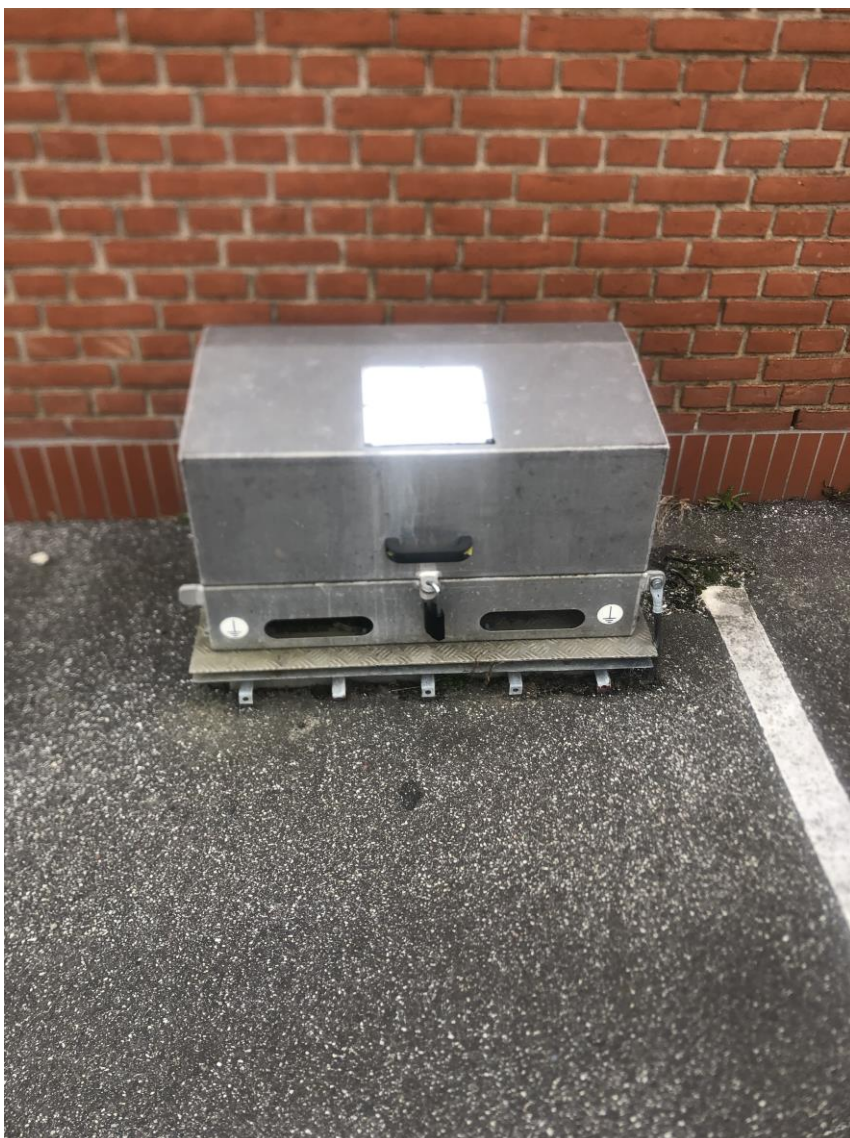
Billede 2. Påfyldningsplads til olie.
