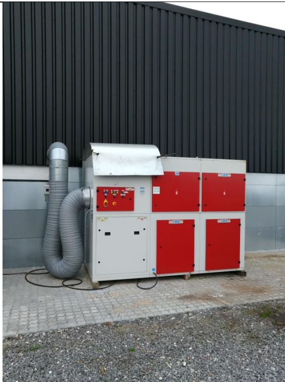
Billede: nr. 2: Udsugningsanlæg til plasmaskæderen.
