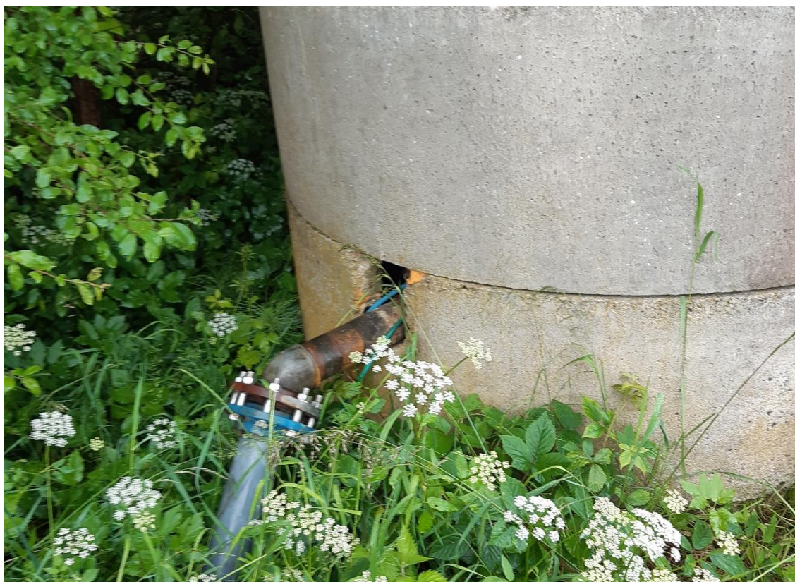
Figur 5: Hul i siden på perkolatbrønden P2
