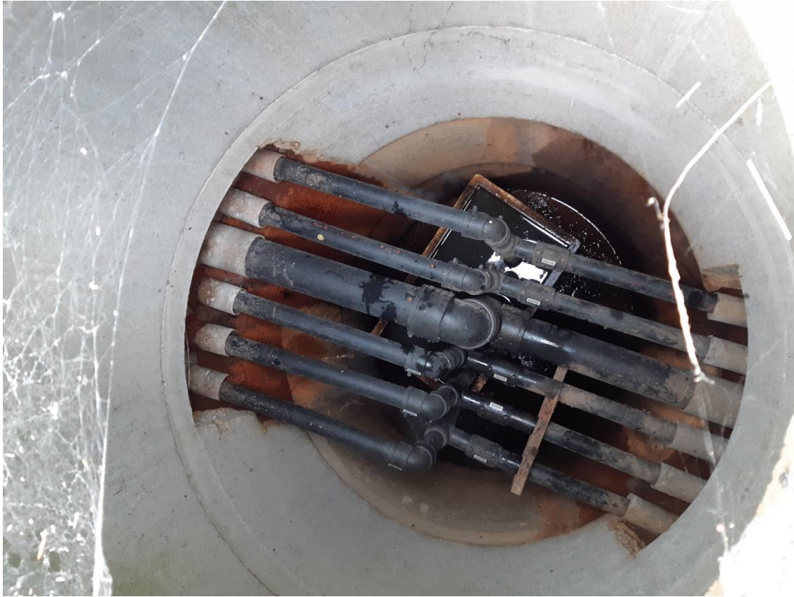
Figur 6: Brønd med rørlægning til gas
