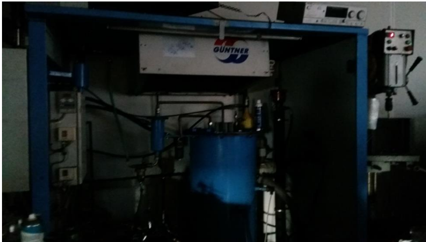
Foto: Anlæg til tømning af kompressorer.
