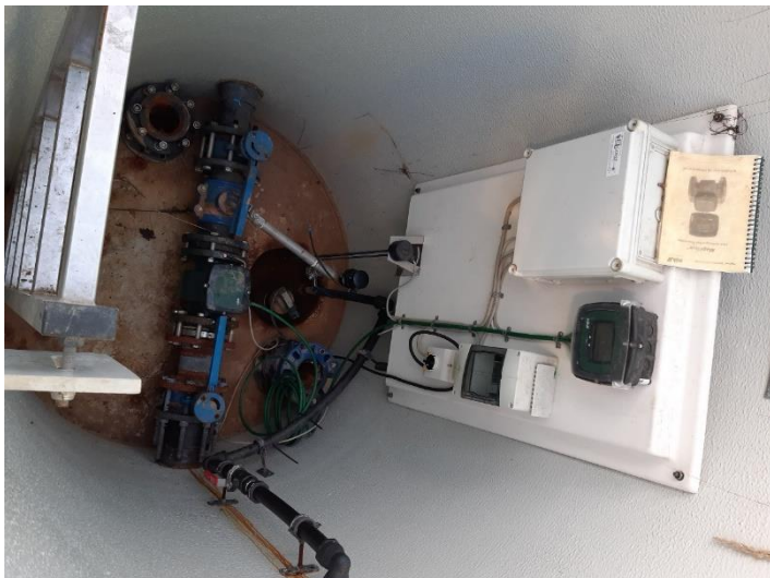
Foto 6: Det indre af perkolatpumpebrønd ved lystbådehavnen
