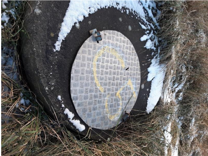
Foto 7: Perkolatbrønd C5 i deponiets vestlige del.
