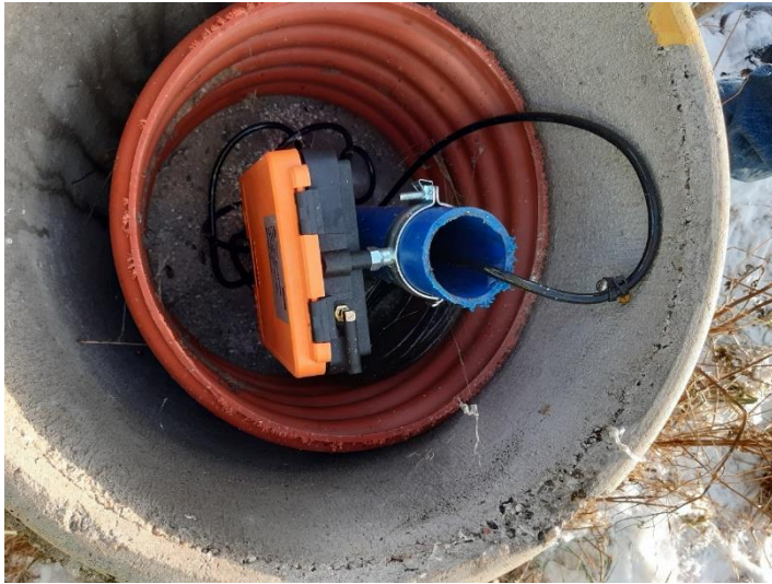
Foto 5: P17 er forsynet med niveaumåler til kontinuert måling af perkolatstanden i deponiet.
