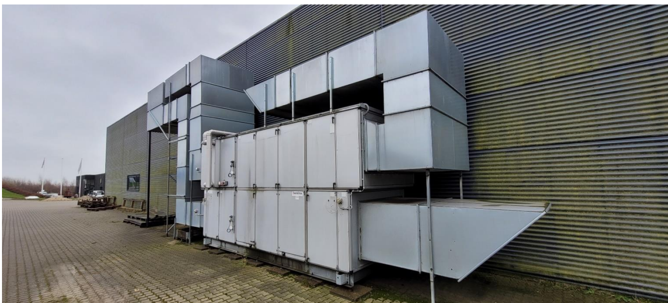
Varmegenvindingsanlæg på rumudsugningen.
