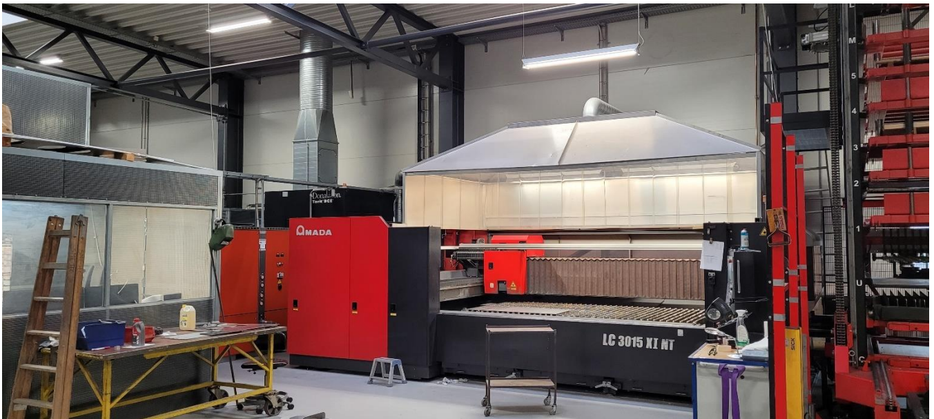
Laserskærer med tilhørende luftfilteranlæg.
