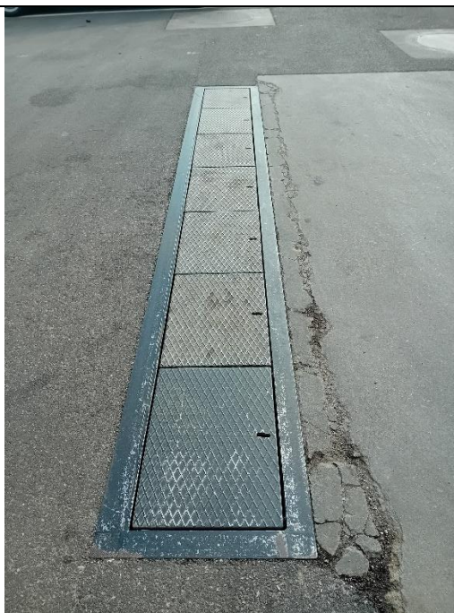
Billede 4: Utæt belægning på påfyldningsplads
