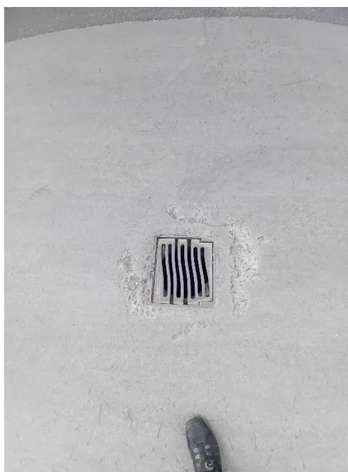
Billede 3: Utæt belægning på salgsplads
