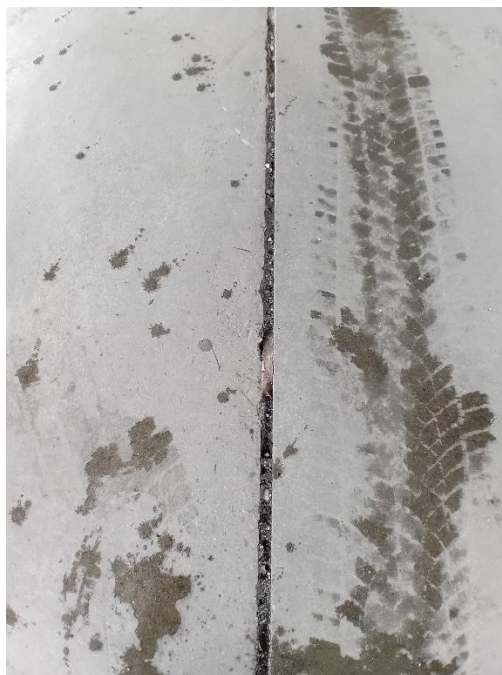
Billede 2: Utæt belægning på salgsplads
