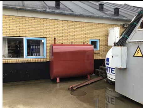
Ny olietank placeret udendørs.
