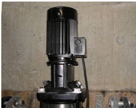
Figur 3.22 Tanktømmepumpe TP 02 i ventilbygværk.
