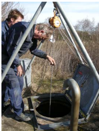
Figur 4.4 Dæksel på centerpumpebrønd CP1.
