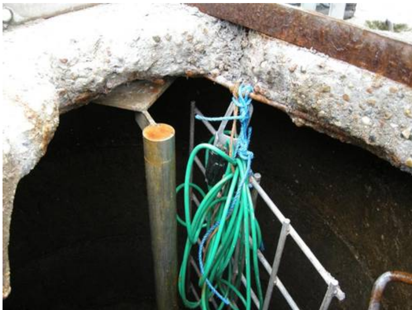
Figur 3.13 Guiderør for CP3 og ophængning af kabel til tryktransmitter i CP3
