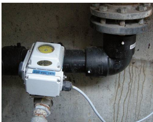
Figur 4.19 Motorventil MV01 på rør for slangetømning via TP 01.
