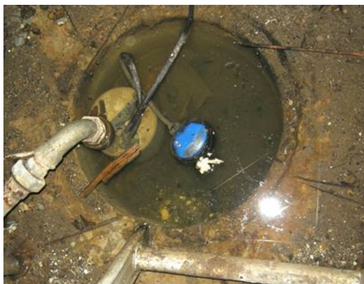
Figur 3.21 Sump i ventilbygværk med kælderpumpe
