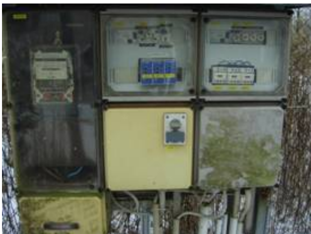
Figur 3.28 Hovedkrafttavle for hele slaggedepotet. (ældre billede)
