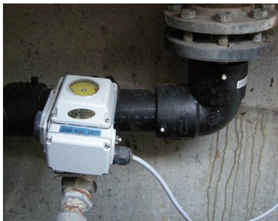
Figur 3.26 Motorventil MV01 på rør for slangetømning via TP 01.
