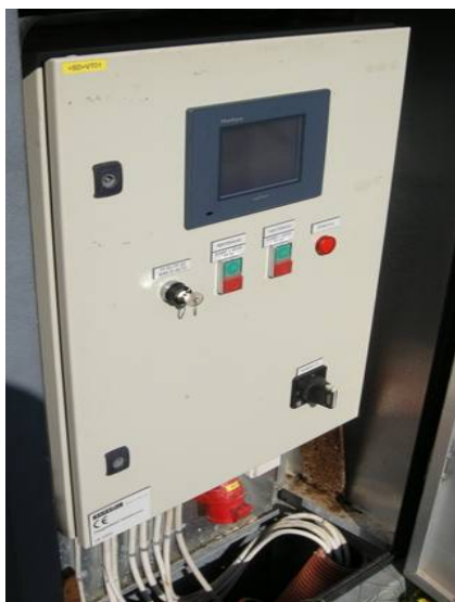
Figur 4.23 Frontpanel på styretavle ved ventilbrønd
