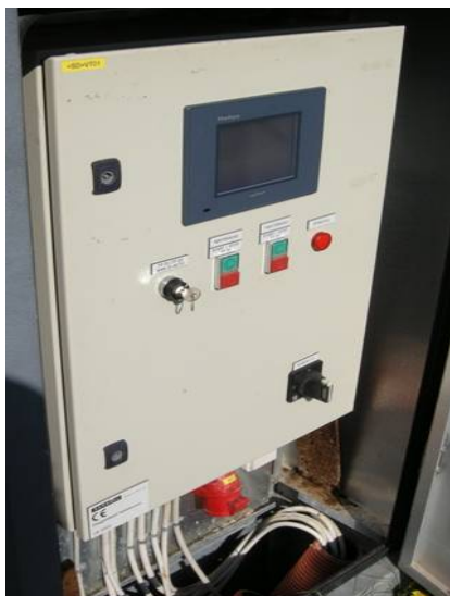
Figur 3.27 Styretavle for buffertank og ventilbygværk.
