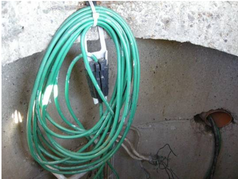
Figur 3.12 Ophængning af kabel til tryktransmitter i CP2.
