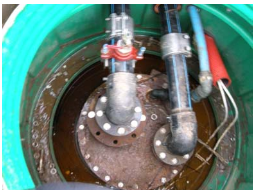
Figur 4.21 Dæksel i buffertank med sugerør for TP02 og tilløb fra deponierne
