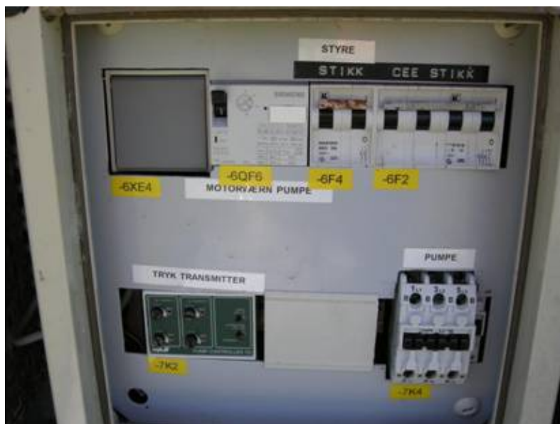
Figur 3.11 Lokal styretavle for pumpe CP2
