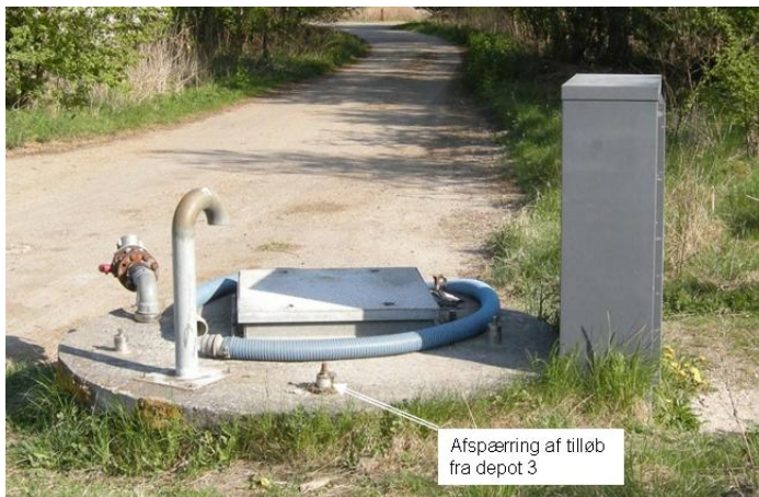
Figur 3.20 Ventilbygværk med kobling for oppumpning på tankbil.
