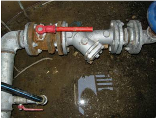
Figur 3.25 Ventil og si før rørtømmepumpe TP 01 i ventilbygværk.
