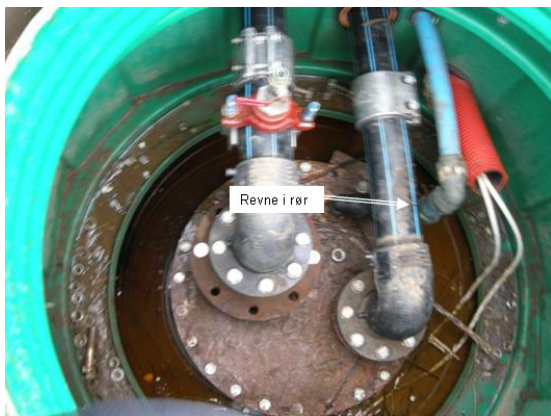
Figur 3.18 Rørdedføringer på sydlige dæksel på buffertank.
