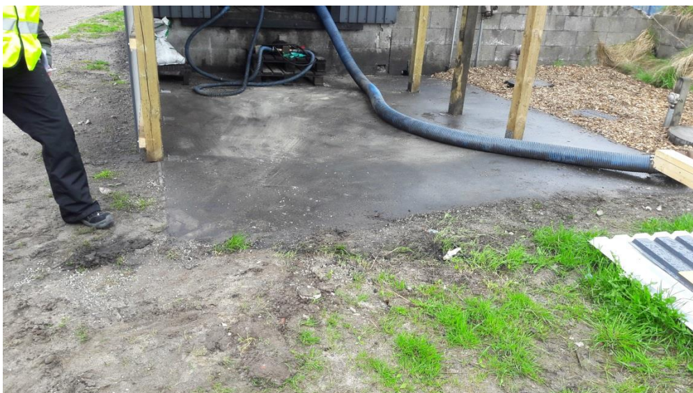
Figur 1. Betonstøbt plads foran bygning med spildolietank med sortfarvning af areal udenfor betonstøbning og under flis.
