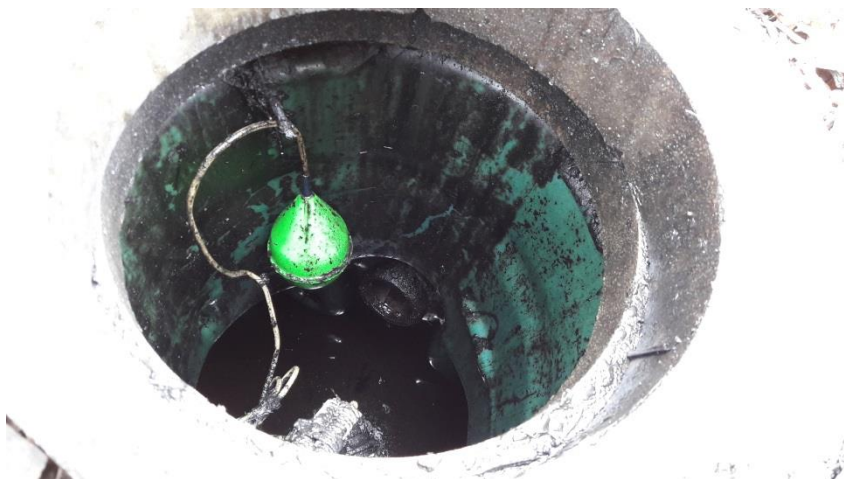
Figur 2: Billede 1-3 viser olieudskiller med tilhørende brønde placeret umiddelbart op af betonstøbt plads ved spildolietank
