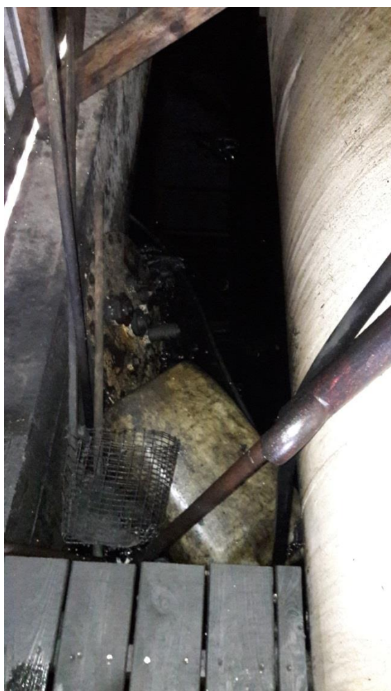
Figur 3: 10.000 L spildolietank ses til højre i billedet, mens opsamlingskar ses til venstre i billedet, hvor det anes, at en del af karet er fyldt op pga. spild.
