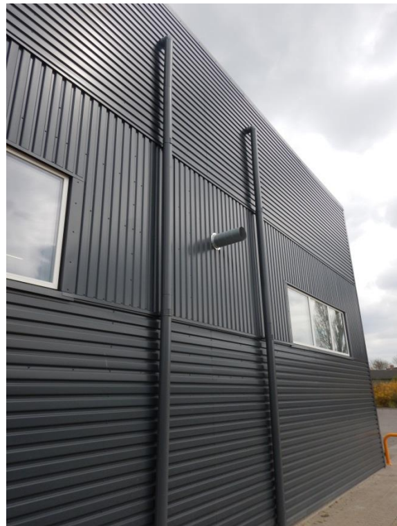
4. Afkast fra nyt værksted – endnu ikke ført over tag.
