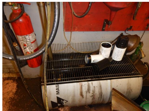
6. Spildolie med pumpe til spildolietank.
